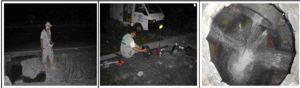
Figura 1 Búsqueda de Fugas
